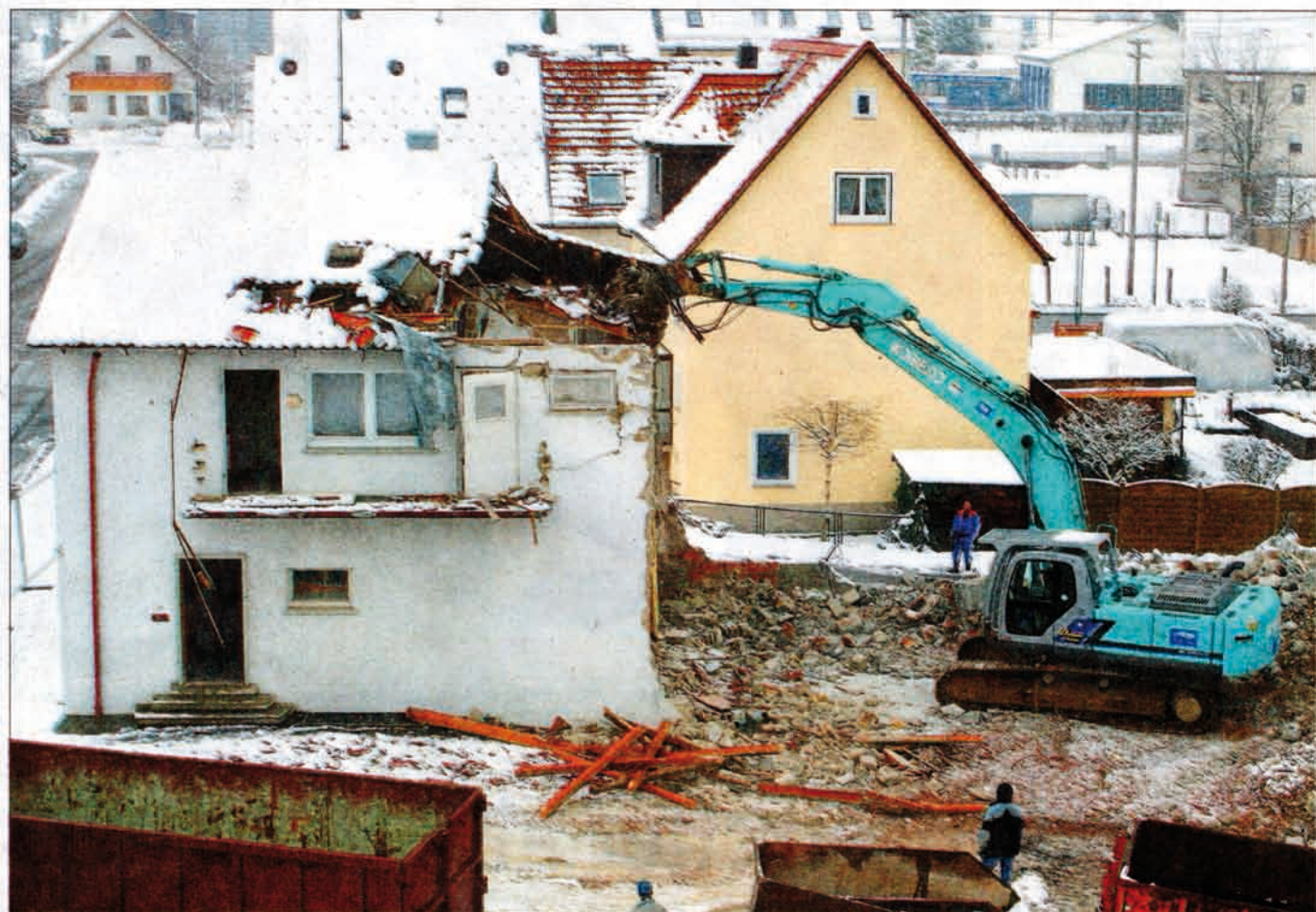
Seit Anfang der Woche war der Abriss des früheren Onstmettinger Kinos im Gange. Mittlerweile ist das Gelände planiert; im kommenden Jahr baut die Firma Johs. Boss darauf eine Fertigungshalle. Foto: Johs. Boss
